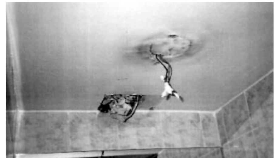
Aspiratore e plafoniera mancante
